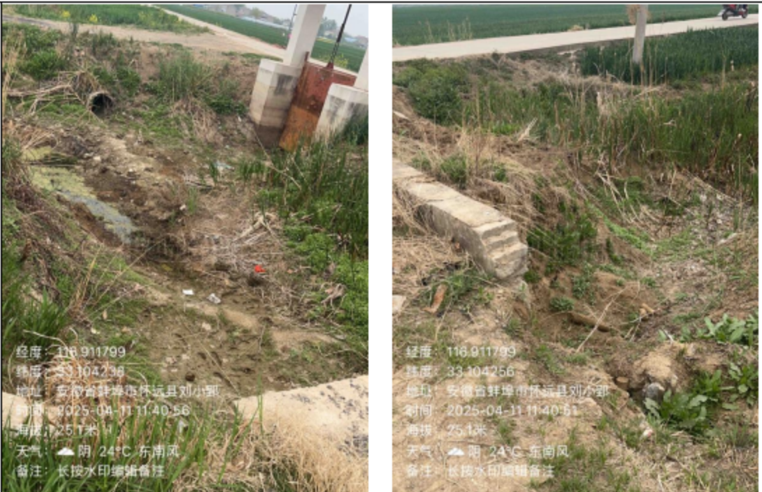
图 2-8 涵洞现状照片
